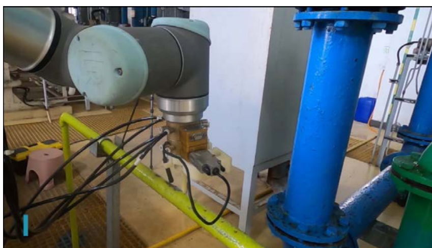
图 6-16 定位管道漏点
