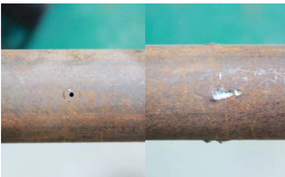
(f) 管道漏点与 50^\circ 管道修复效果
