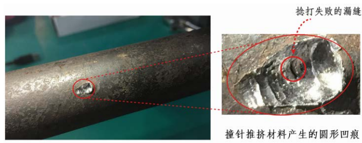
图 6-2 堵漏失败情况出现的缝状泄漏
