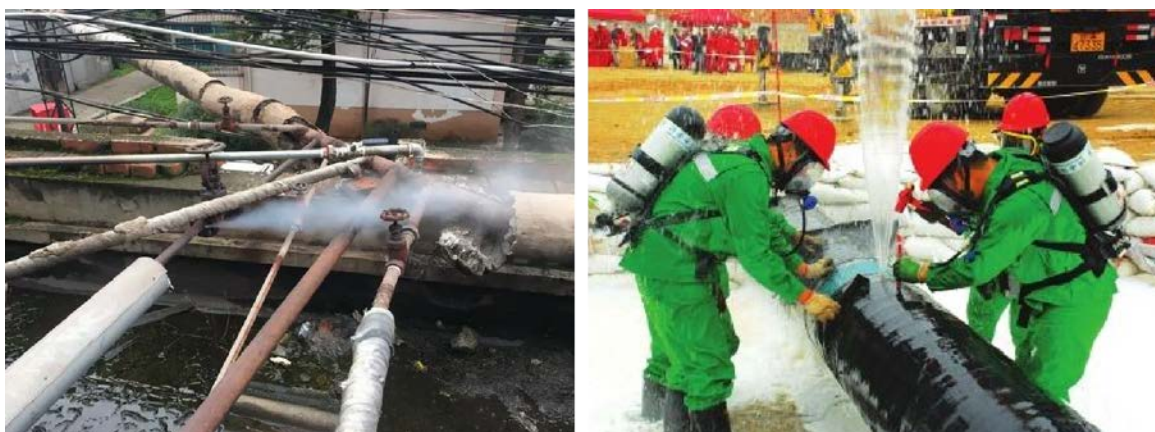
图 1-1 管道泄漏与人工修复
