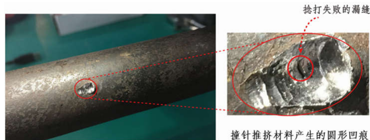
图6-6 捻打堵漏失败情况出现的缝状泄漏
