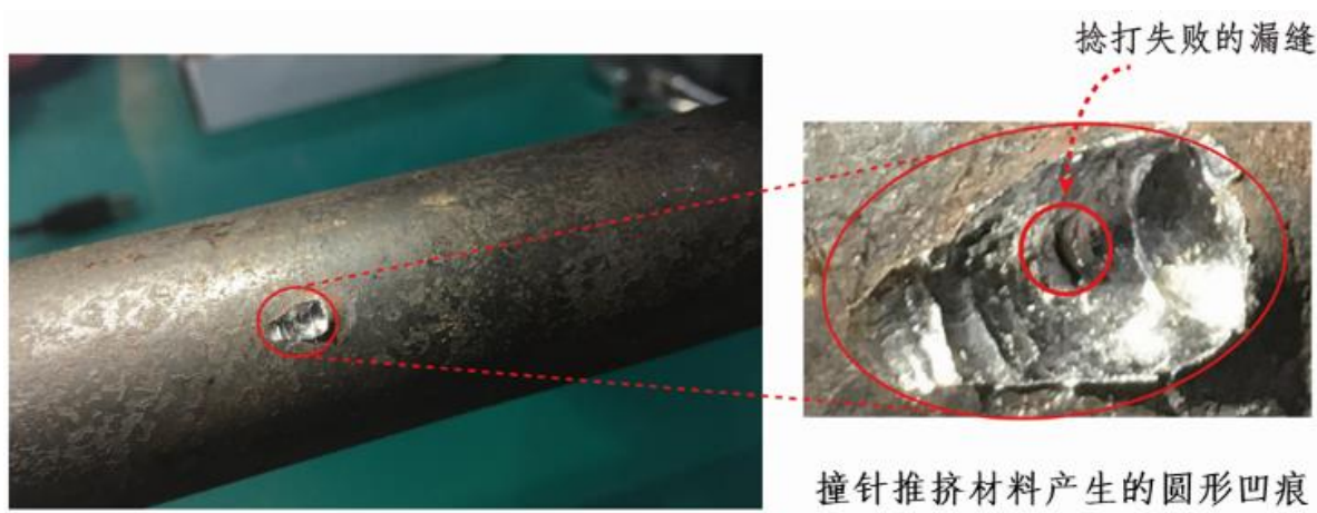
(b) 堵漏失败情况出现的缝状泄漏
